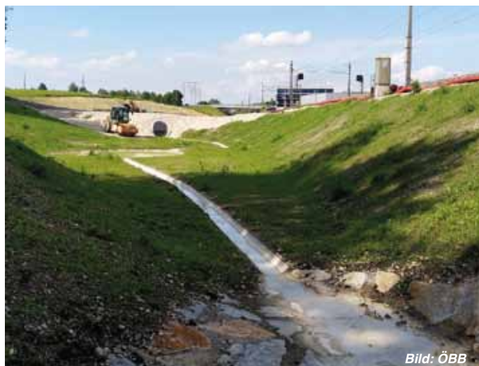
Im großen Retentionsbecken wird das Wasser gesammelt.
